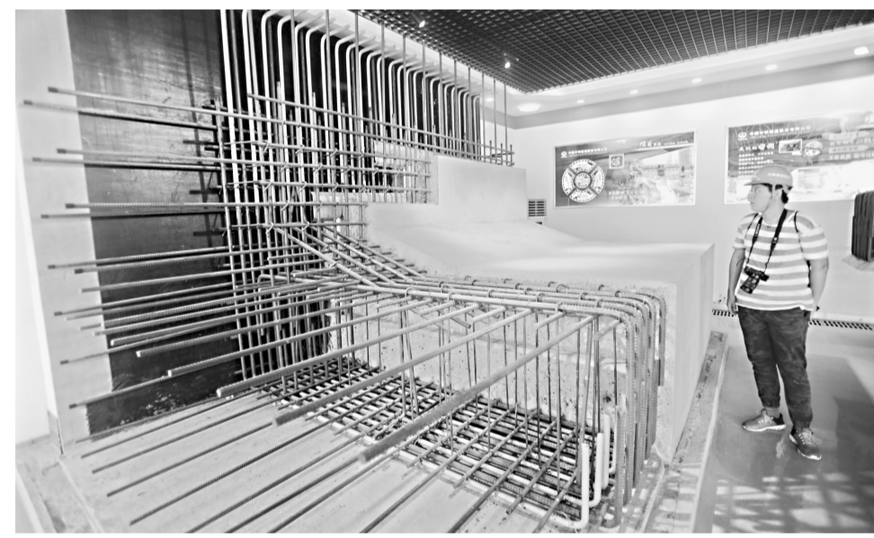
10日,工人在地铁样板间学施工标准 长江日报记者苗剑 实习生宋修宇 摄
